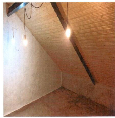
Colocação de ferro no teto e pintura do armazém da Junta de Freguesia
